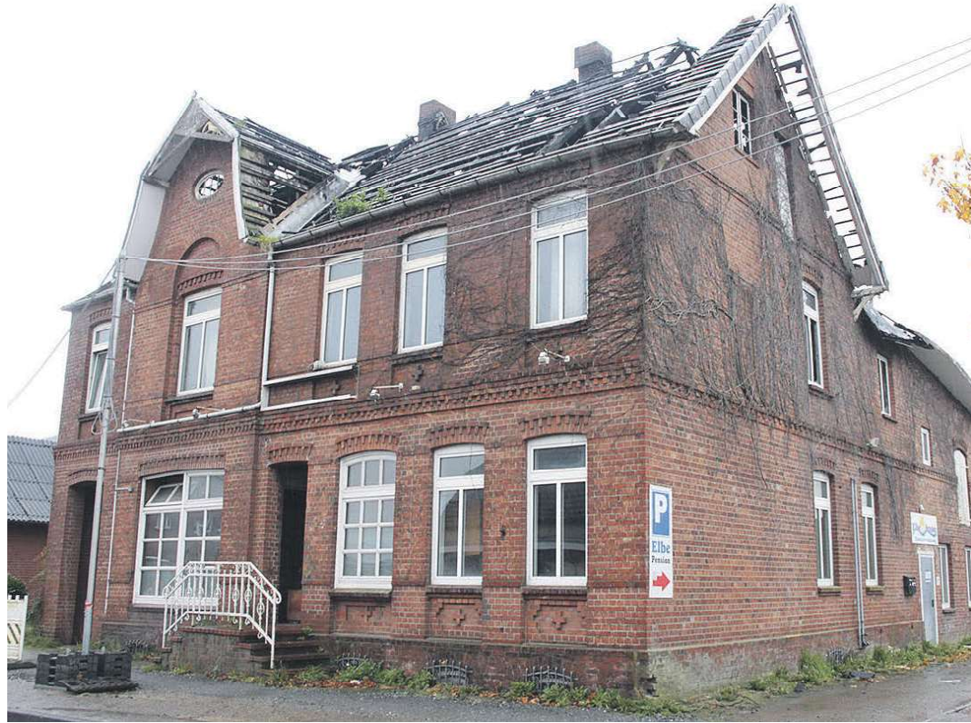
Die Brandruine mit beschädigtem Dach Foto: tp
