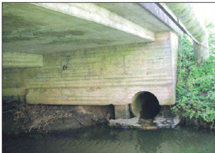
Nur vor dem dicken Rohr, mit dem das Oberflächenwasser in den Kanal geleitet wird, ist die Uferbefestigung unter der Brücke beschädigt: Muss die AES die Sanierung bezahlen? Foto: oh
