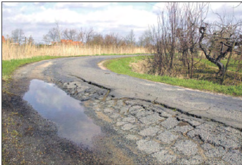
Die alte Asphaltdecke ist versackt und weist breite Risse auf, in denen Fahrradreifen stecken bleiben können: Für die Erneuerung des Wirtschaftsweges sollen die Anlieger 48.750 Euro beisteuern Foto: hr
